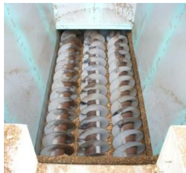
Instalace v podávacím šneku (elektrárna na dřevo)
