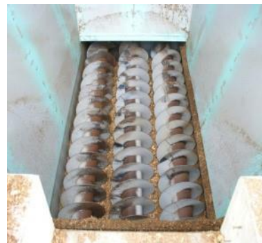
Instalace v podávacím šneku (elektrárna na dřevo)
