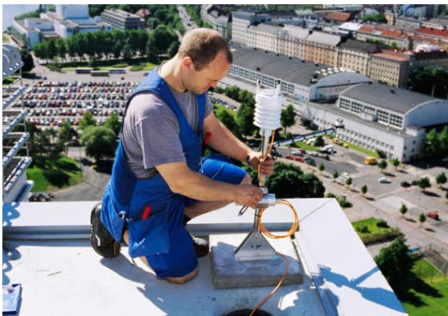
Přístroj WXT520 byl nainstalován na vrcholu 72 m vysoké věže olympijského stadionu ve finských Helsinkách
